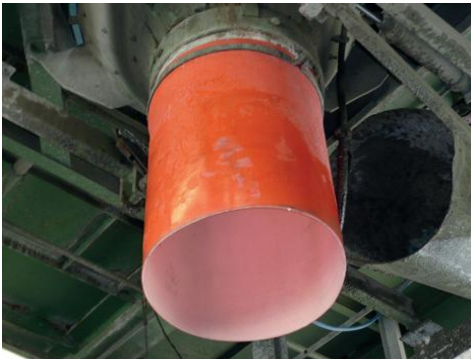
Po umytí nejsou vidět žádné zbytky betonu
